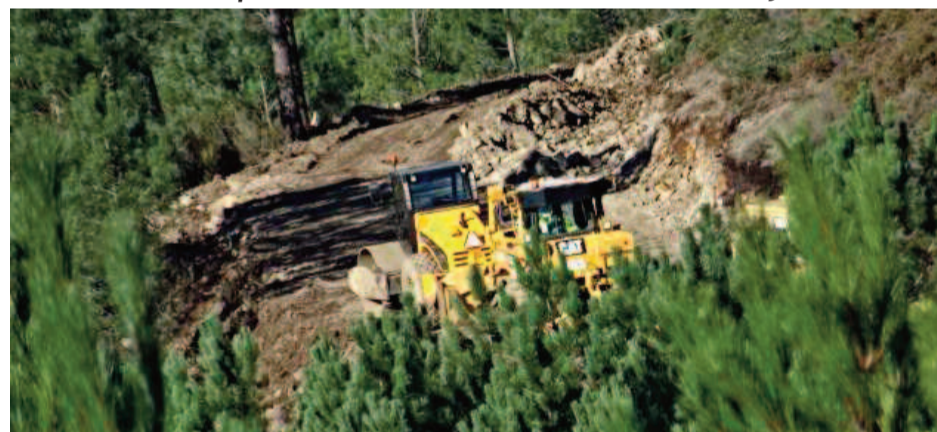
Torre nº 13 na encosta (traseira das antenas) de baldio do Singral
